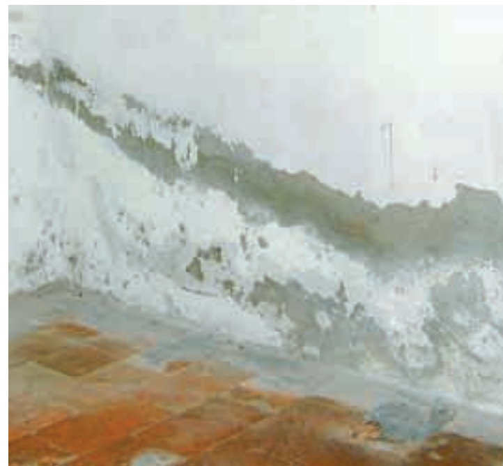
Bauschäden: Die Mangelhaftigkeit des Bauwerkes ist Voraussetzung für die Ausübung von Mängelrechten wie Nachbesserung, Minderung, Wandlung und Schadenersatz. Bilder: HEV
